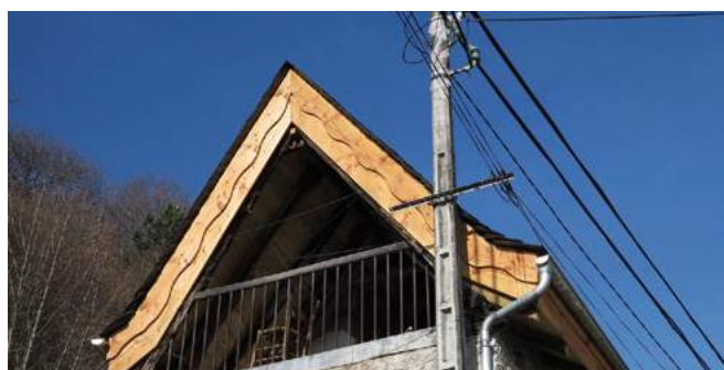
L'isolation en sur-toiture a imposé une surépaisseur et des planches de rive disproportionnées pour une couverture en ardoises qui se veut assez fine.
