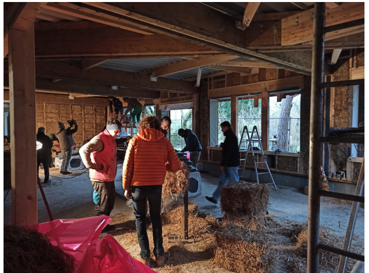
La mise en œuvre des murs en paille a été réalisée en chantier participatif.
