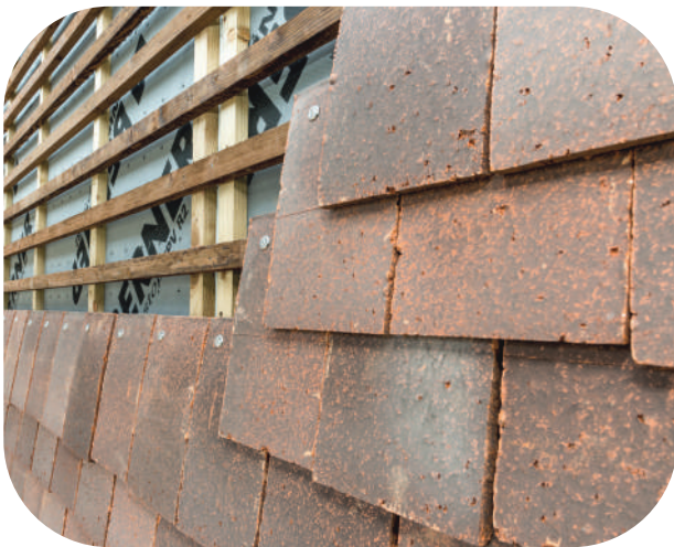
TUILES PLATES EN FAÇADES DÉCLASSÉES
